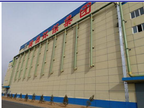
焚烧车间废气收集管道
