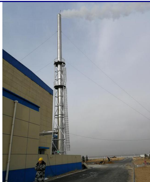
焚烧炉烟气排放烟囱
