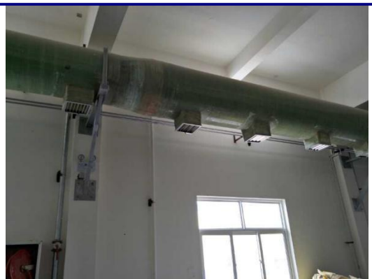
暂存库集气管道
