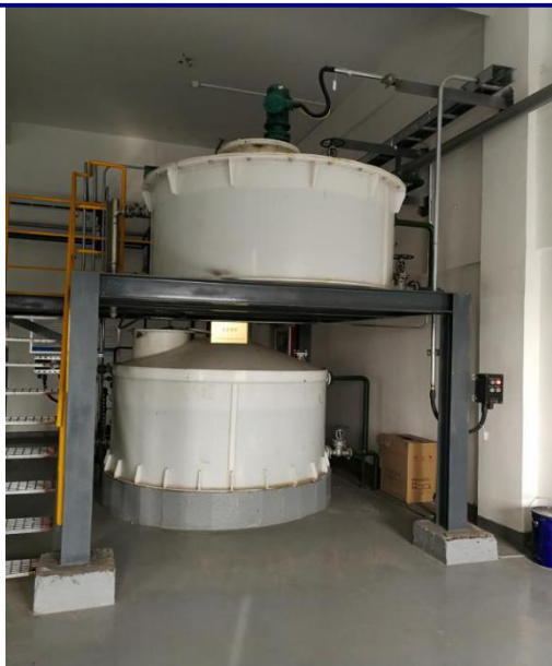
SNCR 脱硝尿素溶液罐
