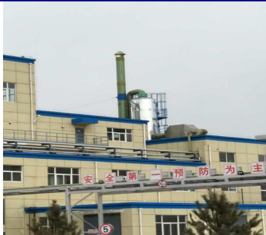
物化车间净化处理系统
